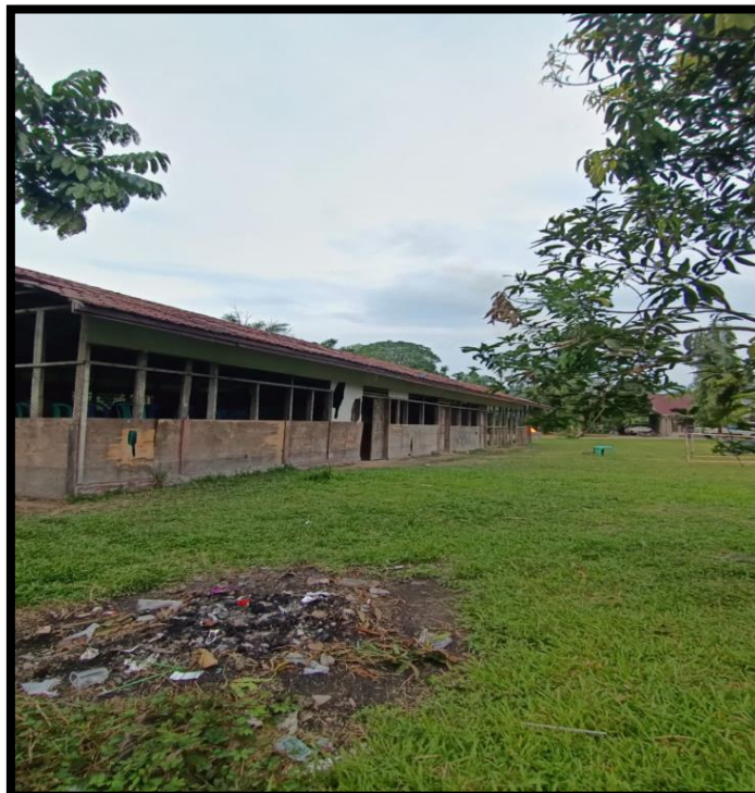
Gambar 2. Halaman Samping Gedung Sekolah Dasar 006 Sekeladi (terlihat tumpukan sampah)
