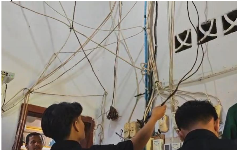
Gambar 2. Kondisi ruang panel
