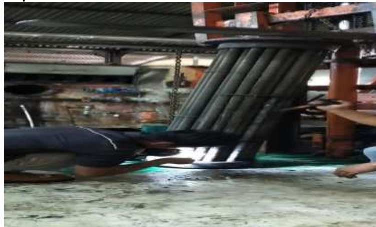
Gambar 7. Damper Saluran Air
